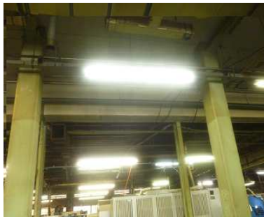
本社第二工場 3か所
